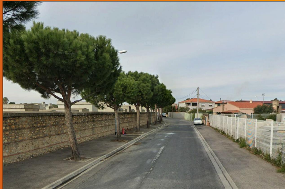
Chaussée déformée par les racines
