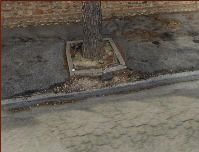
Trottoir défoncé par les racines
