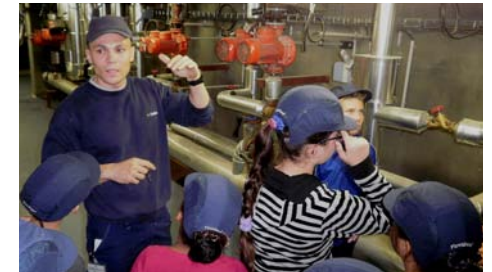
Défi économisons l'énergie à l'école : visite d'une installation
